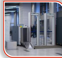
البوابات الأمنية Security Gates
